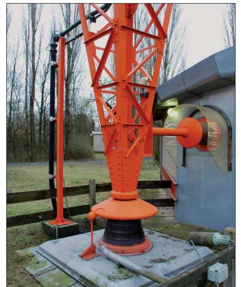
Fuß des 160 m hohen Nordwest-Mastes
