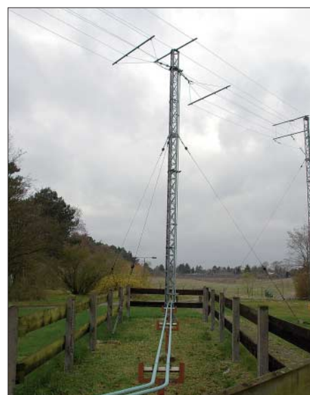
Speiseleitung und Einspeisung der Kurzwellen-antenne
