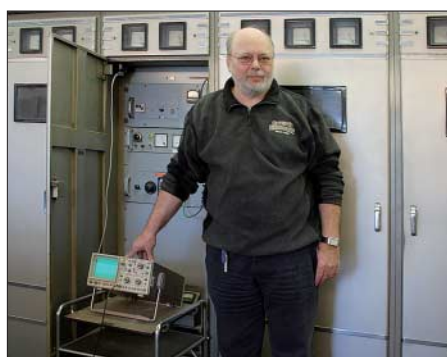
Christian Rady, Ingenieur Programmverbreitung bei Deutschlandradio, hält den ältesten aktiven Kurzwellen-Rundfunksender Euro-pas in Schuss.
