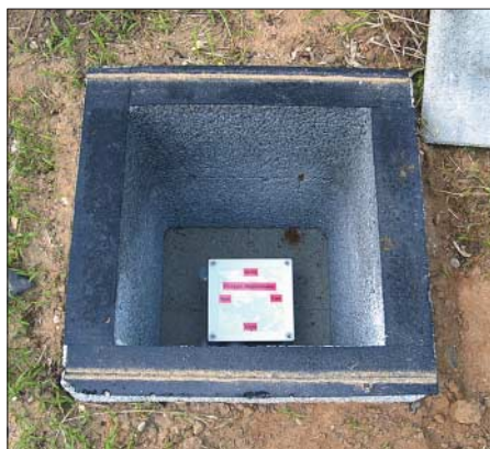
Bild 3: Durch die Versenkung in einem Schacht werden die Umwelteinflüsse minimiert.
