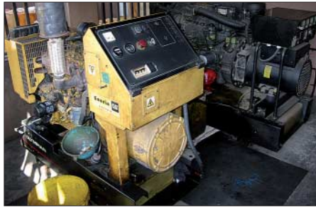
Hauseigene Stromversorgung – in Afrika von unschätzbarem Vorteil
